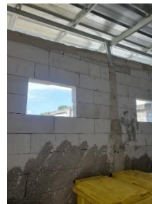
Ventilasi tempat penyimpanan
