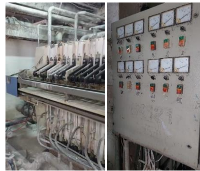
Gambar 4. Mesin Filter Press dan Control panel
